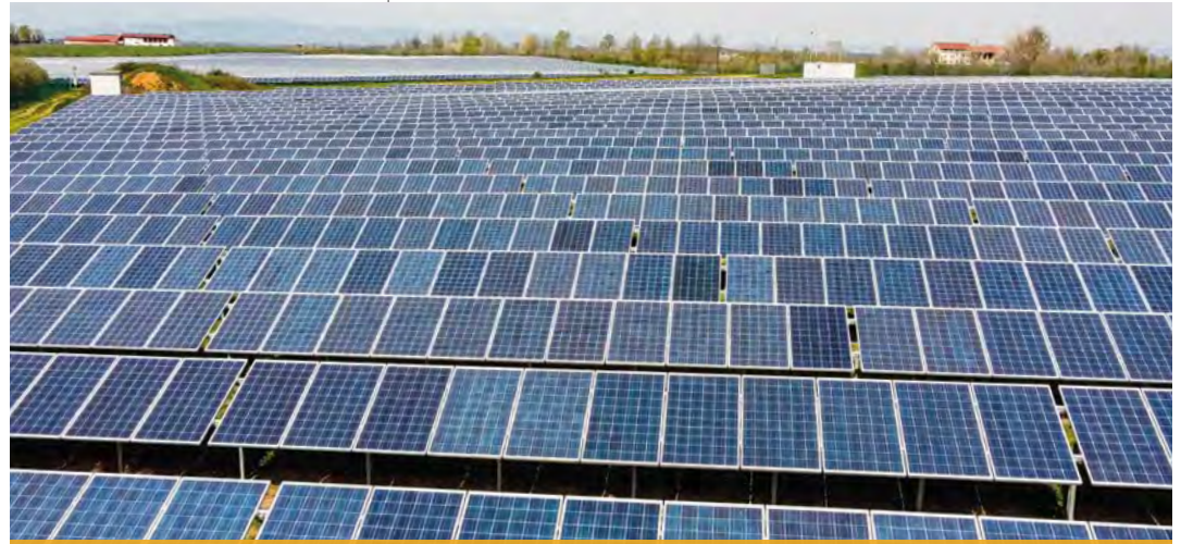
L'impianto energetico già presente in frazione Ternavasso
